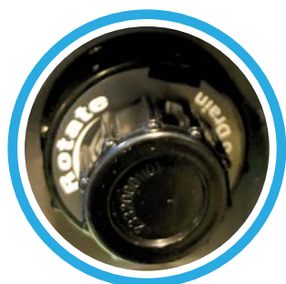
Valve de drainage extérieure
